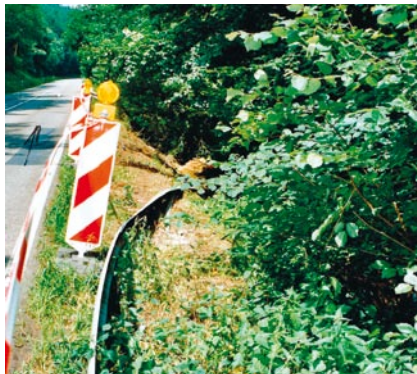
BILD 5: Durchgeschlagene Leitplanke (Blick in Fahrtrichtung Lkw)
